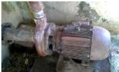
Figura 1. Motor y bomba de la Sede de Peralejo de la UDG (Fuente: Propia).
