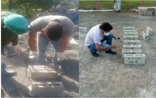
Figura 4: Elaboración de los bloques huecos de hormigón con escoria blanca y cemento portland.
