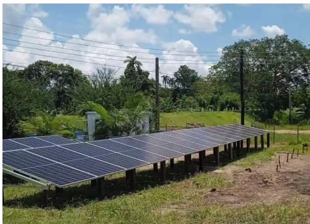
Figura 129. Emplazamiento de paneles solares de la Estación de bombeo de agua, El Jardín.
