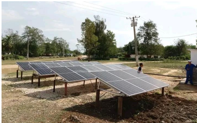
Figura 84. Paneles solares de la Estación de bombeo de agua, La Calera.
