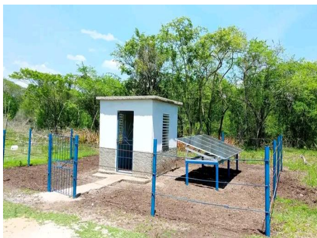
Figura 87. Estación de bombeo de agua, La Canoa.
