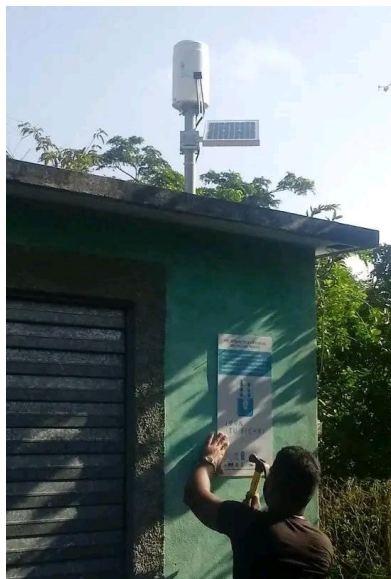
Figura 169. Estación Hidrológica Automática, instalada en el Poblado de tercer orden, Río Blanco.
