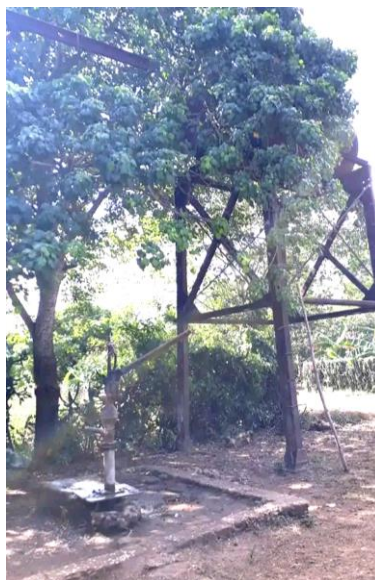
Figura 117. Toma de agua potable del poblado de tercer orden, La Espirituana.
