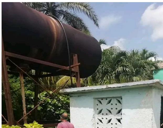
Figura 143. Estación de bombeo de agua, en el Caserío, La Lomita.
