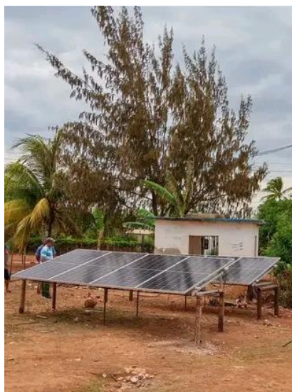
Figura 161. Sistema fotovoltaico, de la Estación de bombeo, del poblado de segundo orden, Pozo Blanco.
